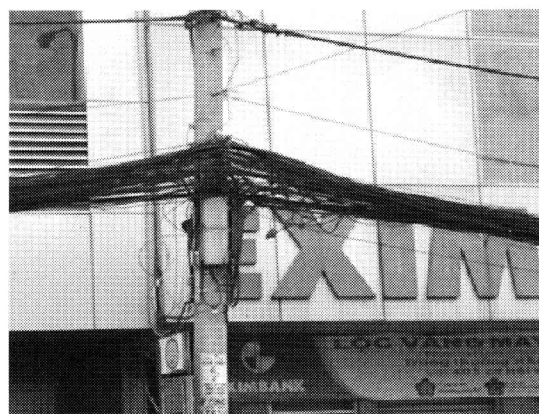
【電柱には無数の電線や電話線が無秩序に張り巡らされている】
